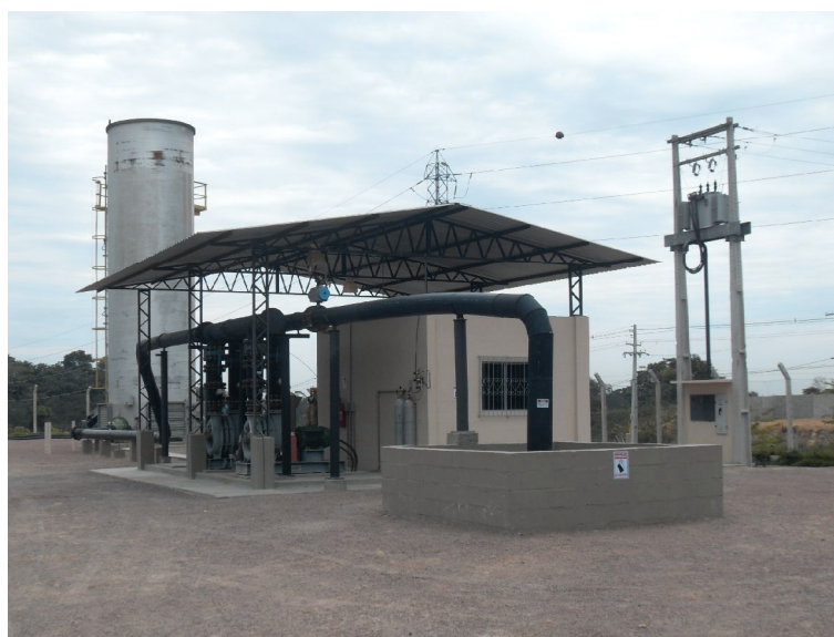
Fig. 9: Usina de gás.
