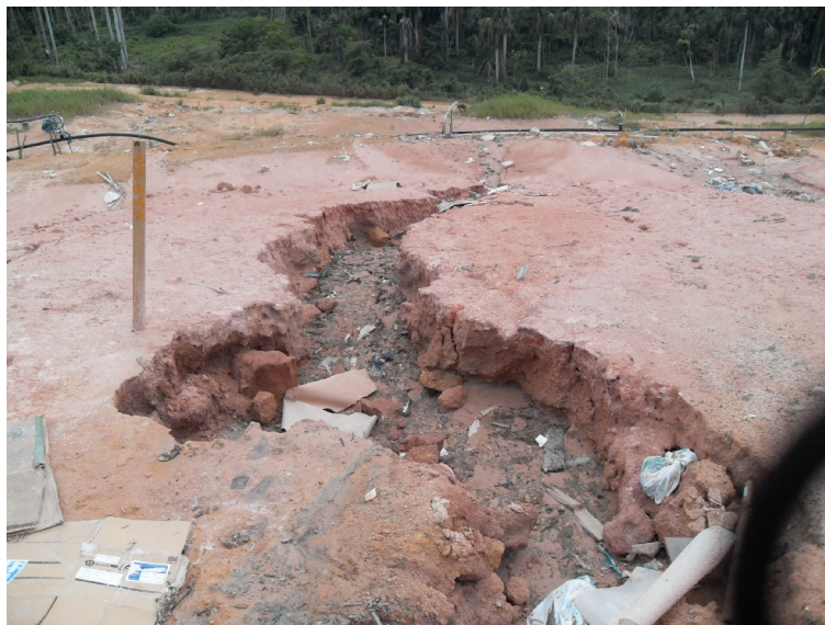
Fig. 1: Erosão das células de deposição.
