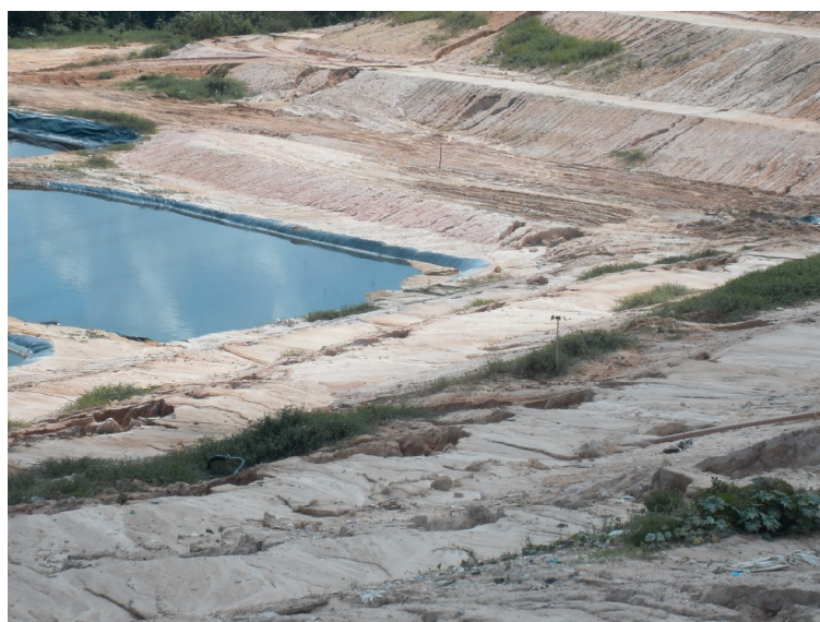
Fig. 2: Erosão das células de deposição, invadindo as lagoas de chorume.
