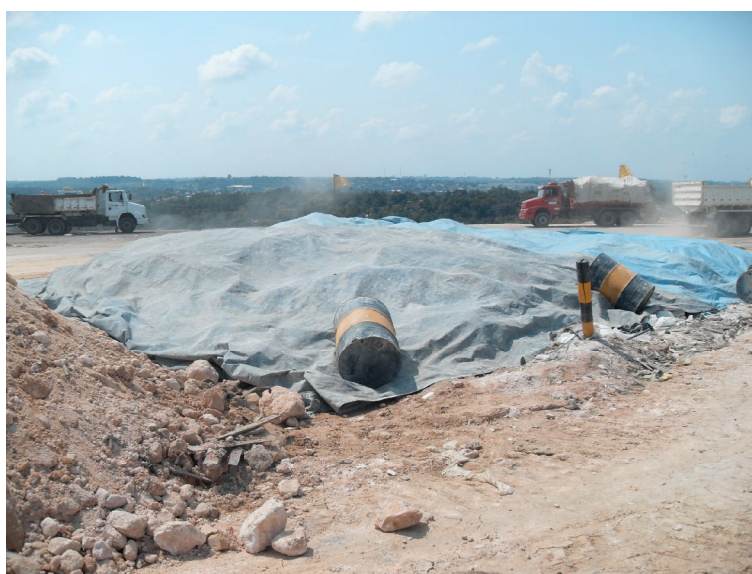
Fig. 6: Cobertura inadequada da vala utilizada para a deposição dos RSSS.
