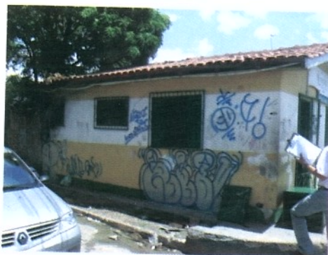
Figura 2- Casinhas com estrutura física inadequada.
